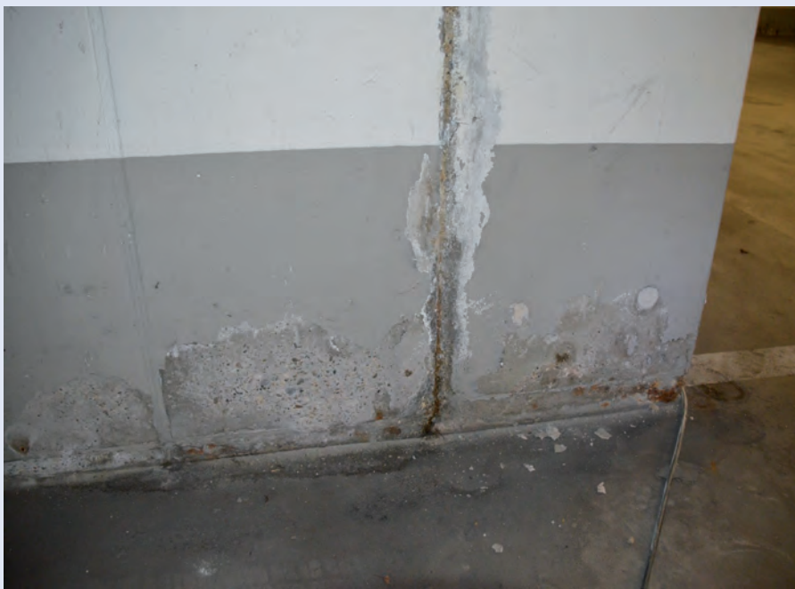
Bild 2: Ausblühungen und Korrosion im aufgehenden Wandbereich
