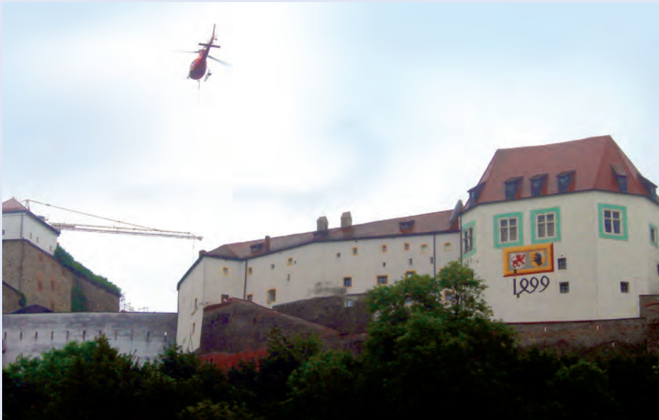
Ein Hubschrauber liefert Material und Gerätschaften an die Baustelle, Quelle: Stadt Passau
