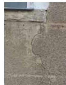
Markante Rissbildung in Außenfassade
